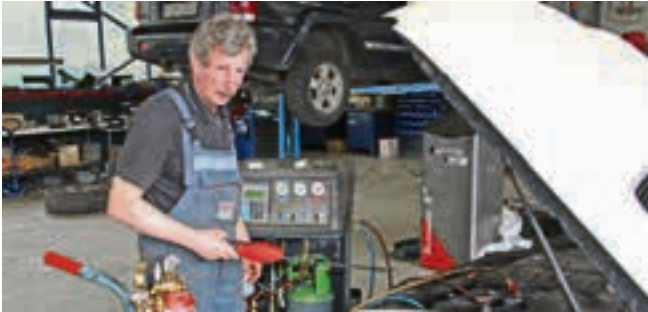
Professionelle Wartung einer Klimaanlage durch Klimaspezialist Jörg Hoppe.
